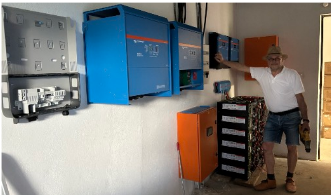
Zonnestroom voor het ziekenhuis
